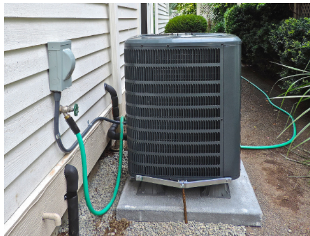
FIGURA 4.14 Fotografía de una bomba de calor (caja grande) situada en el exterior de una casa. Esta bomba de calor se ubica en una zona de clima cálido, como el sur de Estados Unidos, ya que sería demasiado ineficiente ubicada en la mitad norte de Estados Unidos (créditos: modificación de un trabajo de Peter Stevens).
