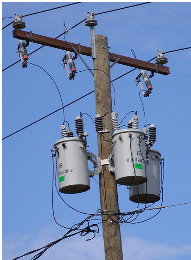
FIGURA 15.21 Los transformadores se utilizan para reducir los altos voltajes de las líneas de transmisión a los 110 y 220 V que se utilizan en los hogares (créditos: modificación del trabajo de “Fortyseven”/Flickr).
